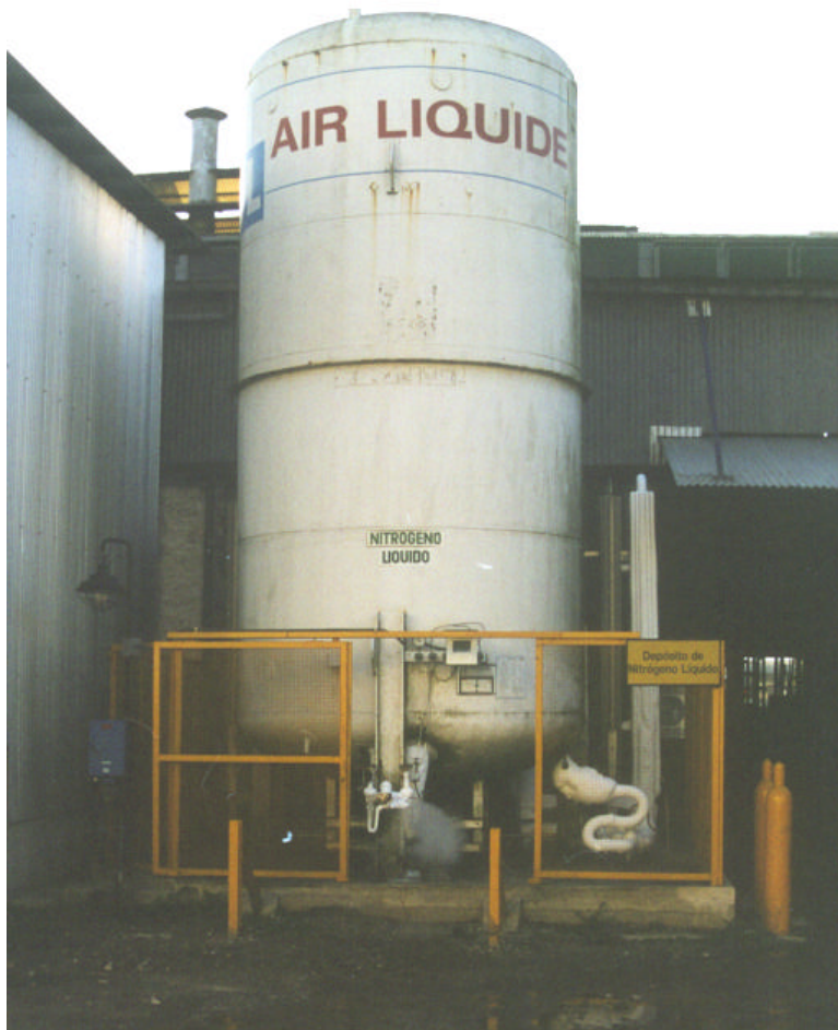
Tanque de Nitrógeno
