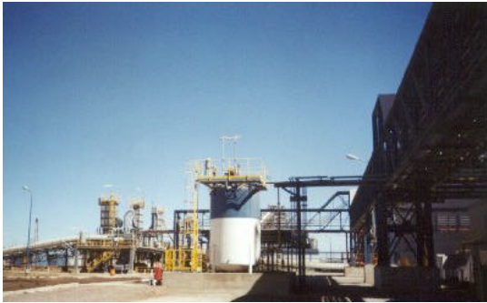
Instalación de Recyfuel
