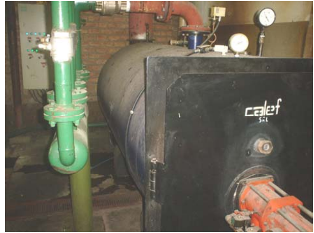
Foto 6: Uso de gas para calefacción de tanques
