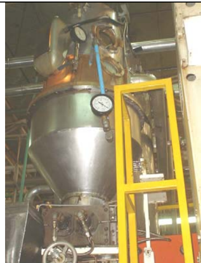
Foto 10: Utilización de vapor en Cocinadores
