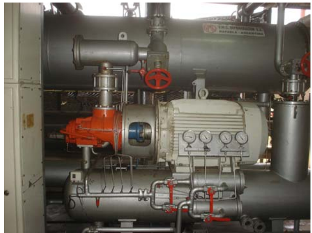
Foto 5: Equipos de frío
